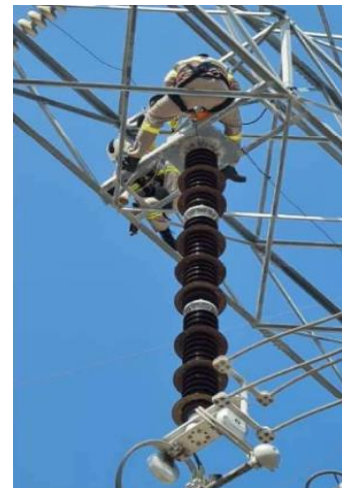
Fig. 11. Instalação do módulo de transmissão do dispositivo de monitoramento.
