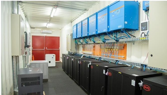
Fig. 2 – Container do sistema BESS
